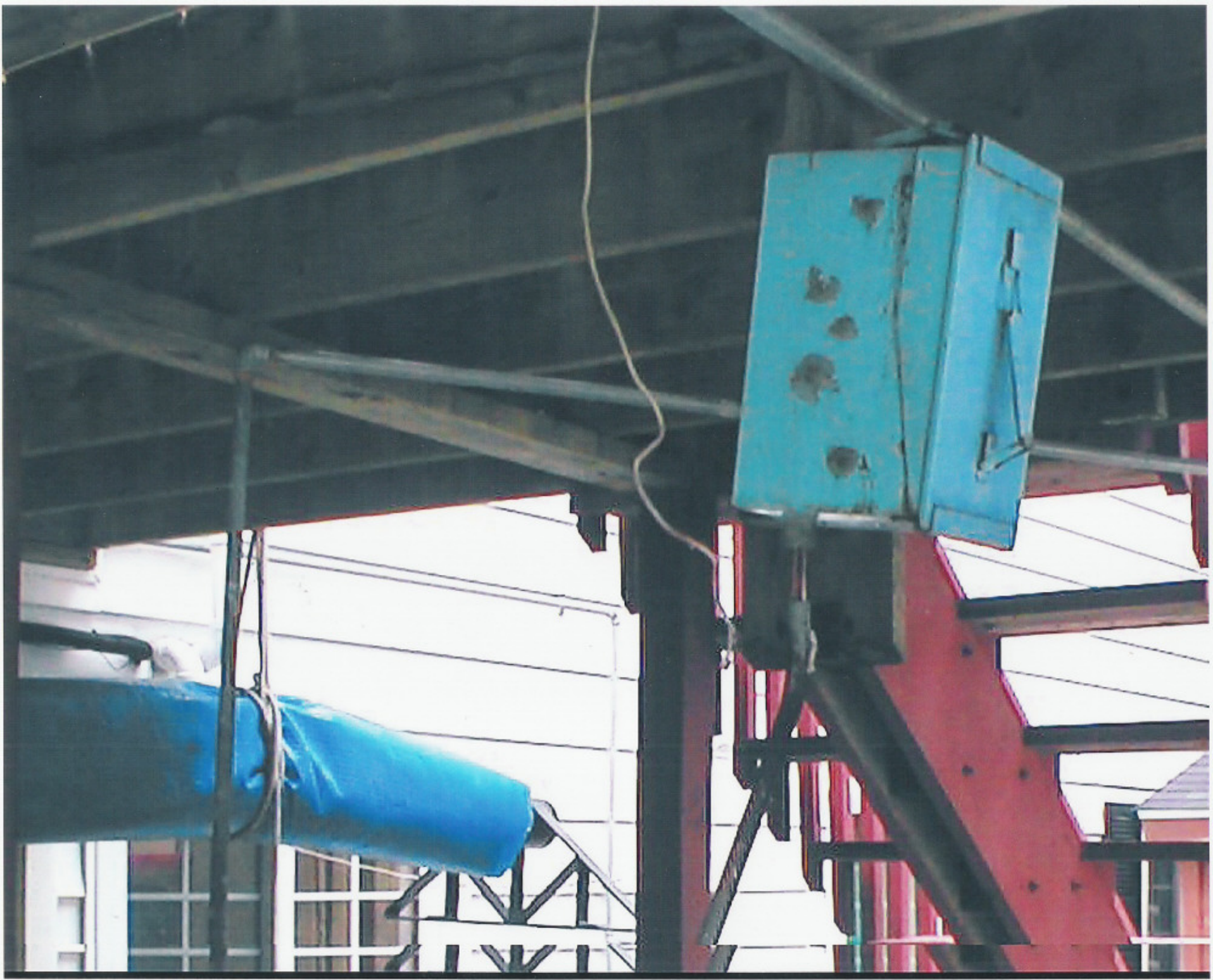
Ammo Box / Electrical Box
